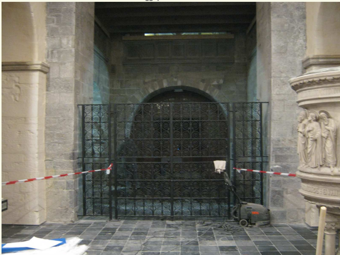
Herstelling uitgevoerd aan het neusje
