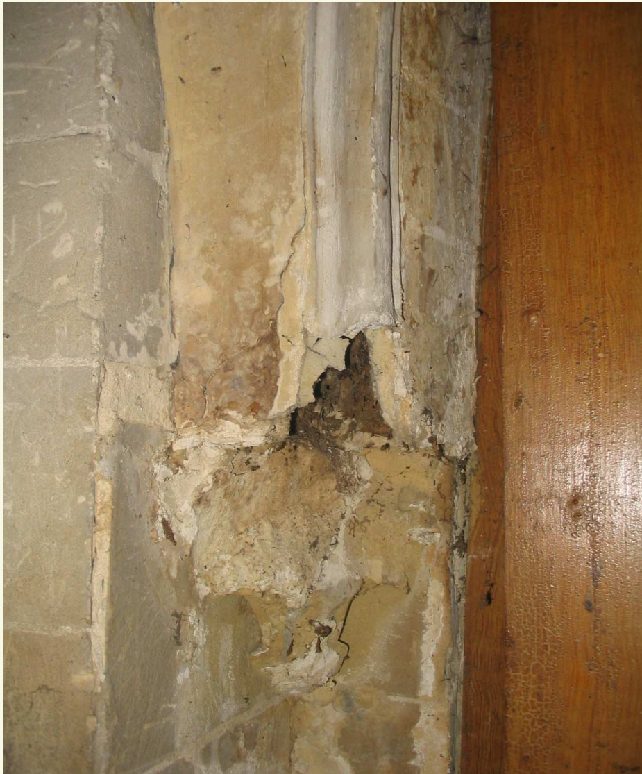
Schadebeeld bij aanvang der werken
